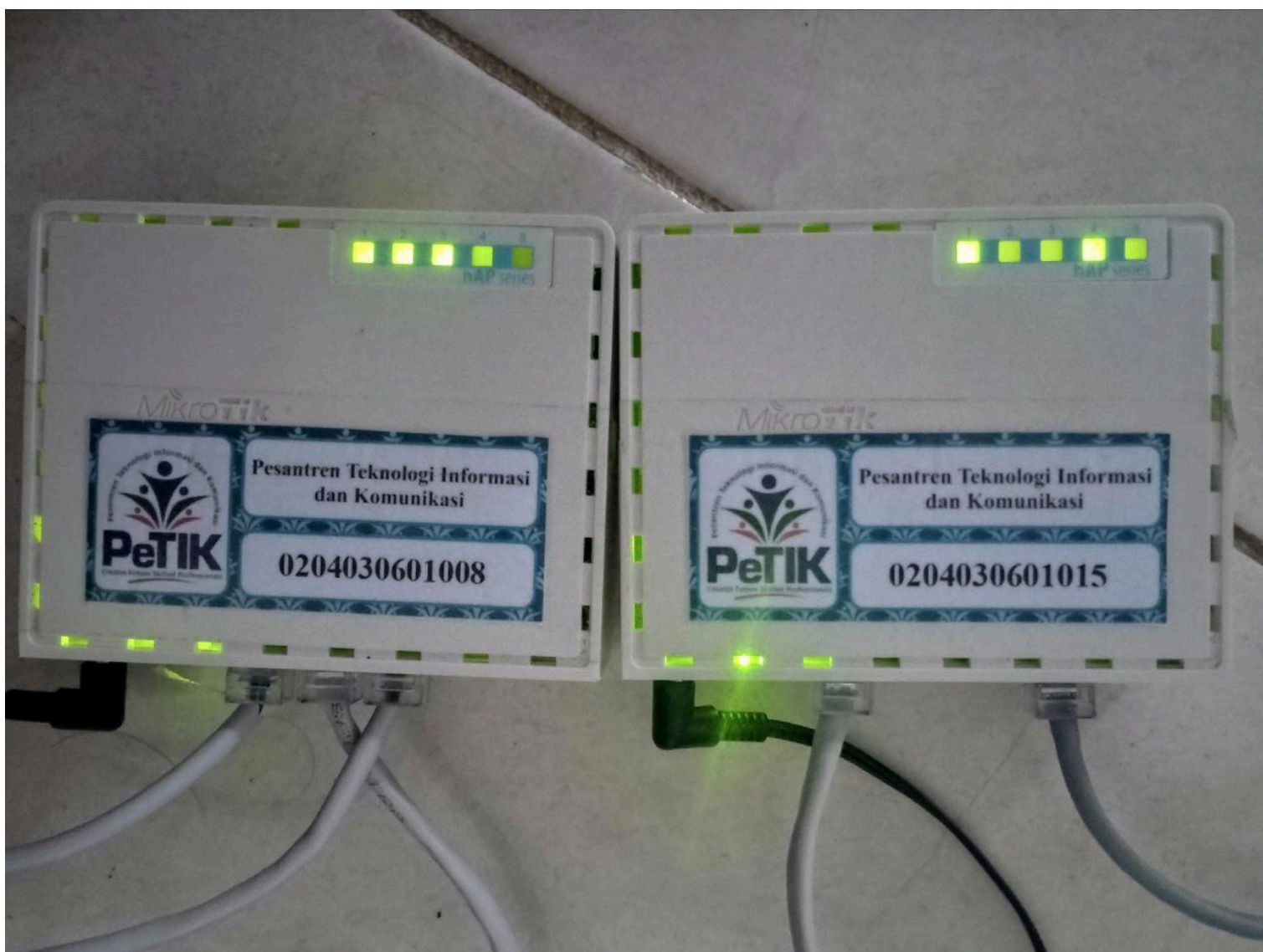
“Gambar sebelah kiri ISP & sebelah kanan SWITCH”
